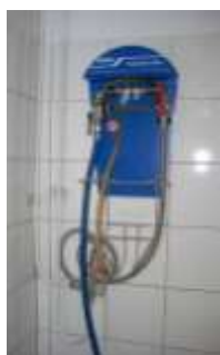
Postes de désinfection alimentés en EFS et ECS
